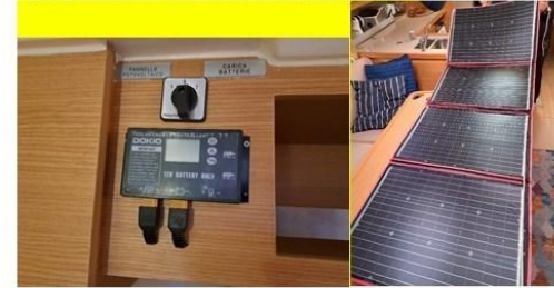
Impianto pannello solare 300 W amovibile con commutatore in cabina di poppa
